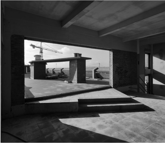
05 Willy Van Der Meeren, Ieder Zijn Huis , Brussels, Belgium, 1953-1961. Restoration of the roof level. © ORIGIN, Georges De Kinder.
