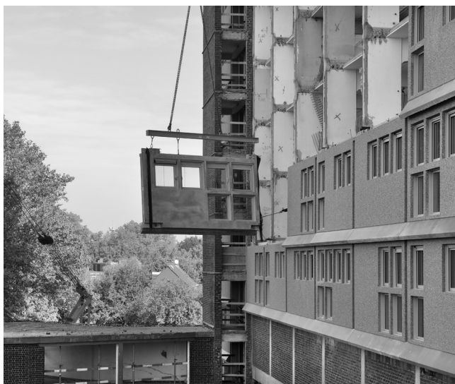
03 Willy Van Der Meeren, Ieder Zijn Huis , Brussels, Belgium, 1953-1961. Recomposition of the façade with the new prefabricated sandwich panels. © ORIGIN, Georges De Kinder.
